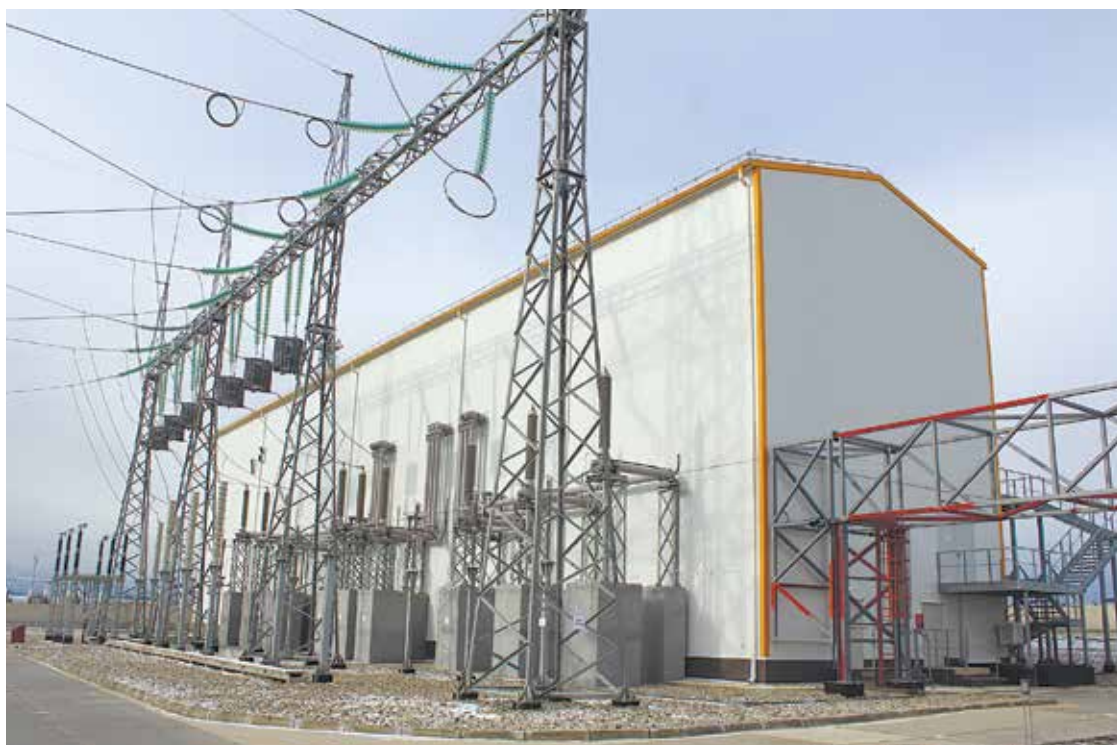
Одна из построенных в рамках проекта по увеличению разрешенной мощности подстанций – ПС-220 кВ – расположена в непосредственной близости от комплекса гидрокрекинга.
